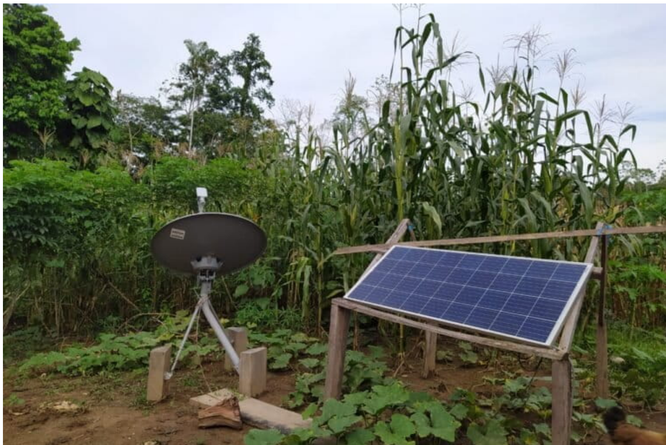
El prototipo de sistema de paneles solares e internet satelital que sirvió como base para un proyecto que llevará energía eléctrica e internet a la comunidad de Alto Mishagua, Perú. Foto: cortesía Roxana Borda
