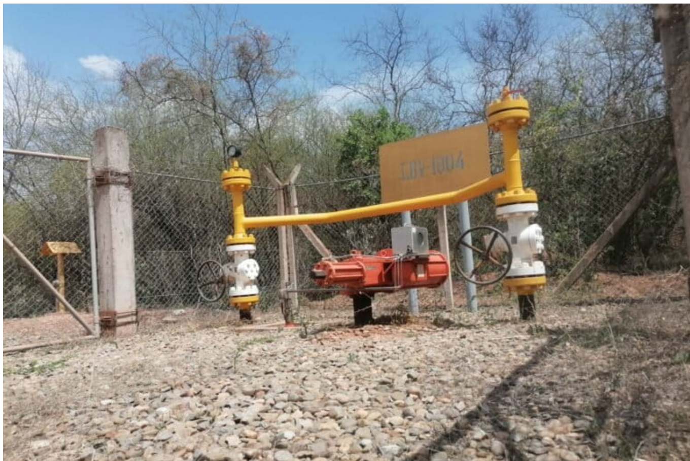
Una de las válvulas del campo petrolero Margarita, instaladas en el camino a la comunidad Yuati. A pocos metros está el Pilcomayo. Foto: Iván Paredes
