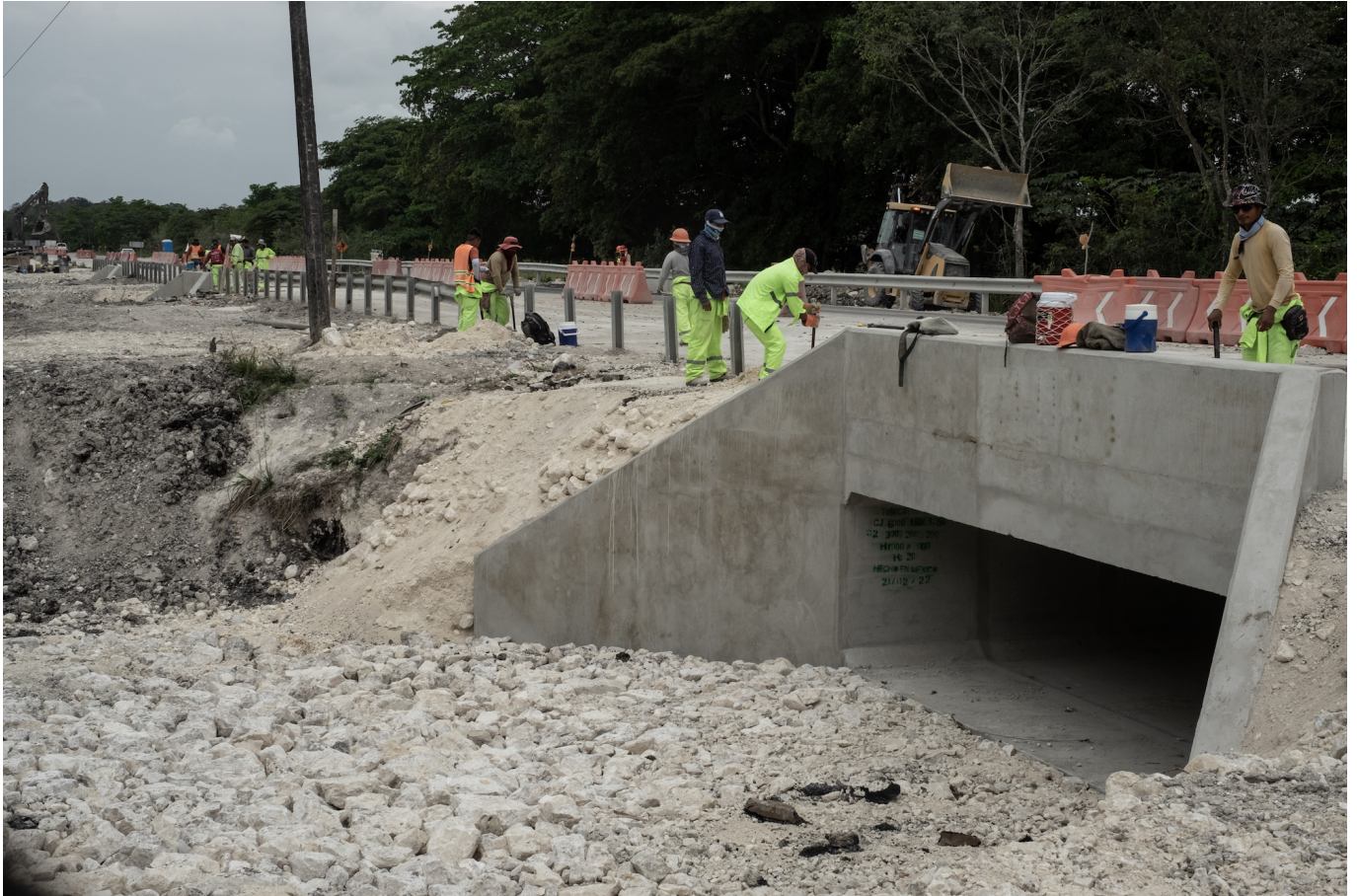
Infraestructura hidráulica y de paso de fauna en la Carretera Escárcega-Chetumal. Foto: Isabel Mateos Hinojosa
