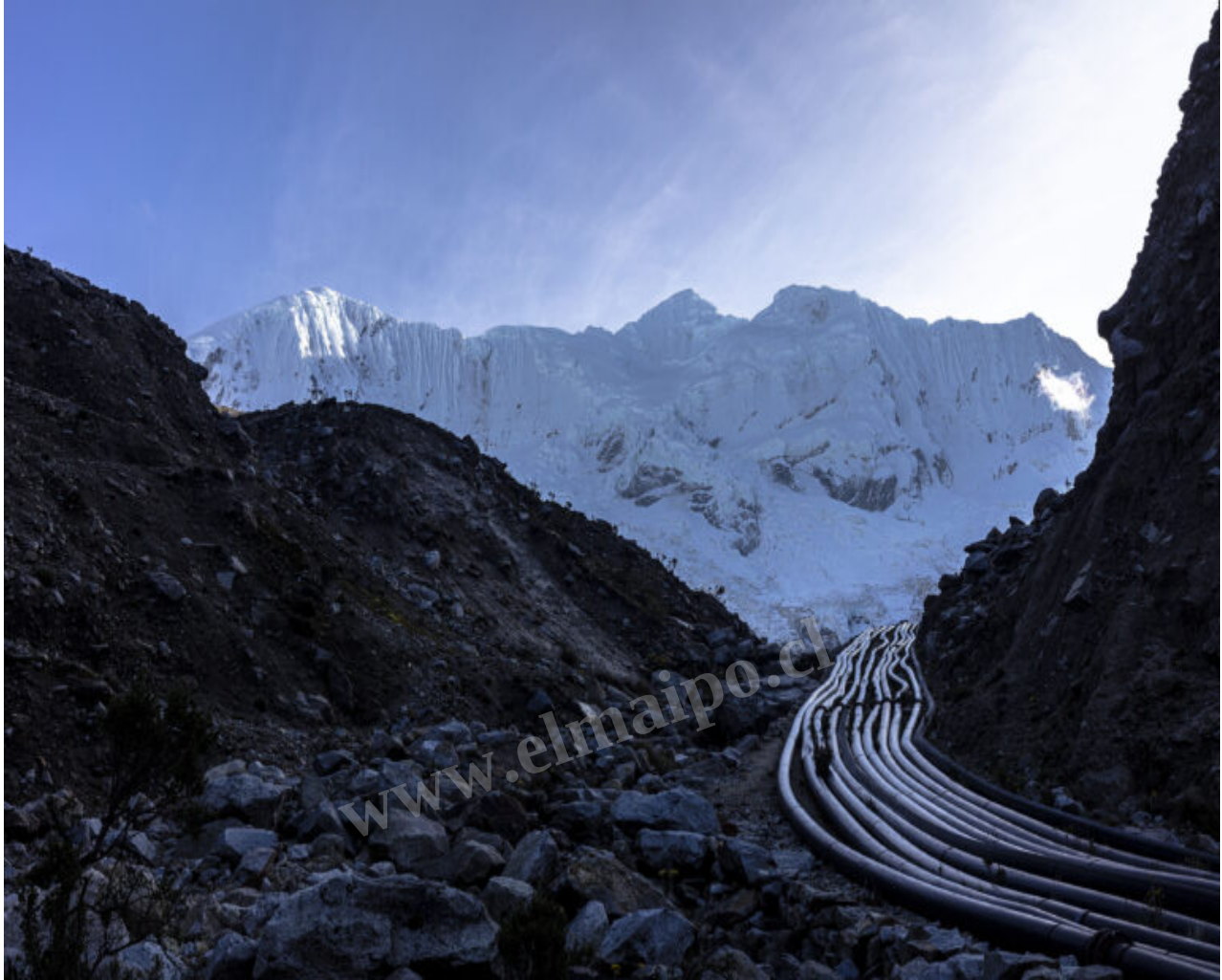
Tuberías provisionales extraen agua de la Laguna Palcacocha. Estas no serían suficientes para proteger la ciudad de una ola de inundación. Foto: Indira Palomino / Germanwatch
